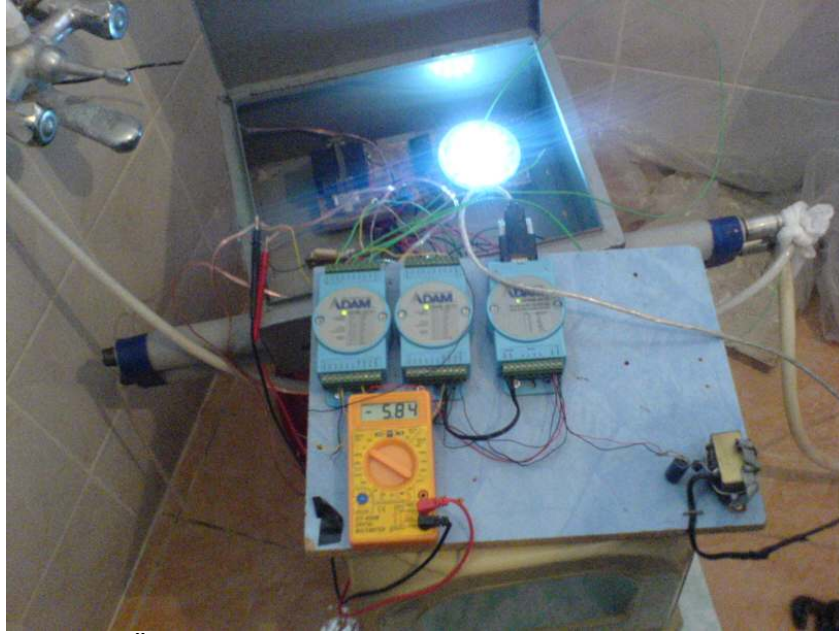
Şekil 4. Üretilen elektrikle LED li aydınlatmanın çalıştırılması.
